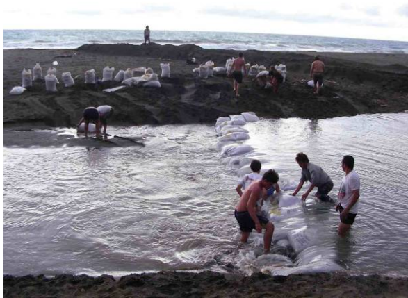
Figura 44. Intento de canalización de Río Oro para evitar su llegada al vivero en playa Pejeperro. Temporada 2006.
